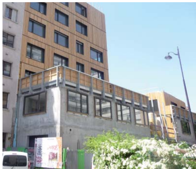
Pose du bardage bois sur les murs en béton (avril 2010) Photo : Atelier Pascal Gontier
