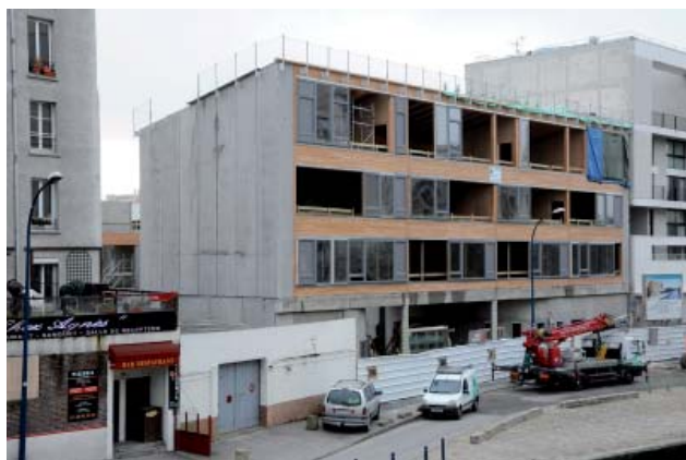
Pose des menuiseries extérieures sur la façade du canal de l'Ourcq (janvier 2010) Photo : Bernard Vaillant
